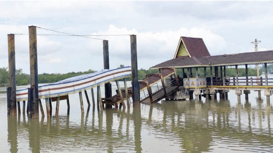
KONDISI ponton di Dermaga Kota Rebah, Tanjungpinang, rusak, Minggu (13/4).
